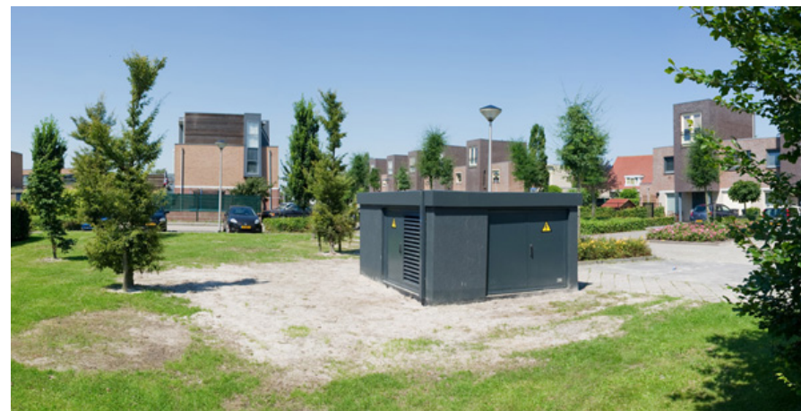
Figuur 38 – Batterijen op wijkniveau
