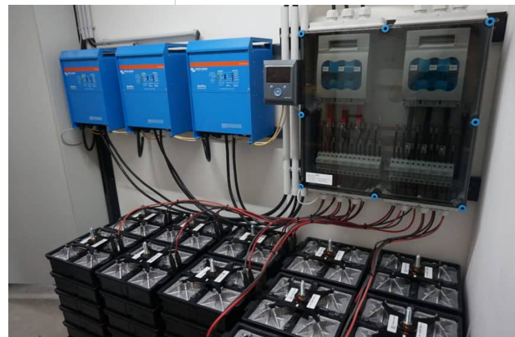
Figuur 30 – Opgewekte elektriciteit opslag in batterijen
