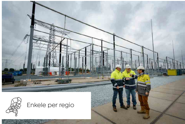
EHS-HS station (van 220-380 naar 110-150 kV)
